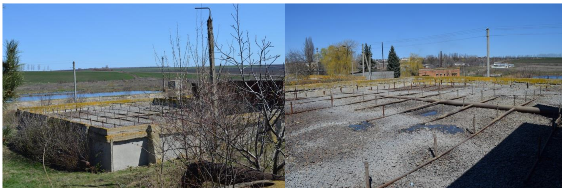
Figura 4-21: Stația de epurare a apelor uzate: Filtre biologice
