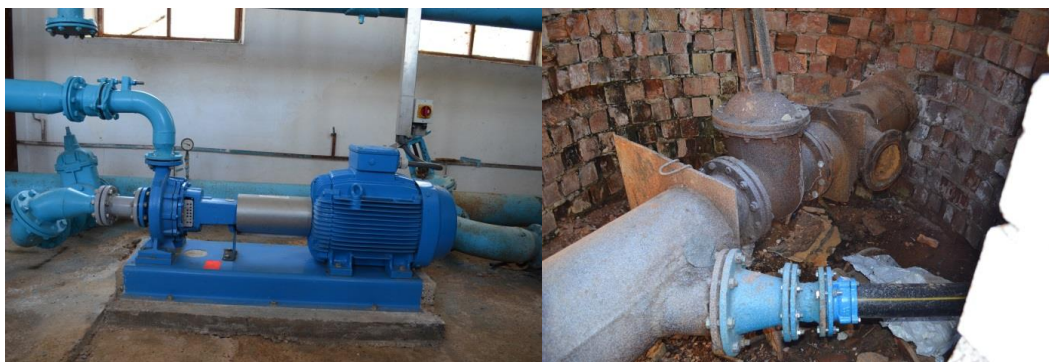
Figura 4-4: Stația de pompare a apei SP-2: agregatul de pompare NT25-250. Nodul de ramificare pentru alimentarea cu apă a Raionului Spitalului și rezervoarelor subterane de apă de pe teritoriul stației de pompare a apei SP-3
