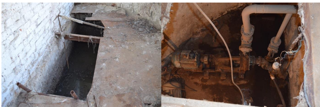
Figura 4-16: Stația de pompare a apelor uzate SPC-3: bazinul de recepție; sala motoarelor
