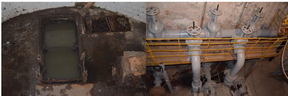
Figura 4-13: Stația de pompare principală a apelor uzate: bazin de recepție; sala motoarelor
