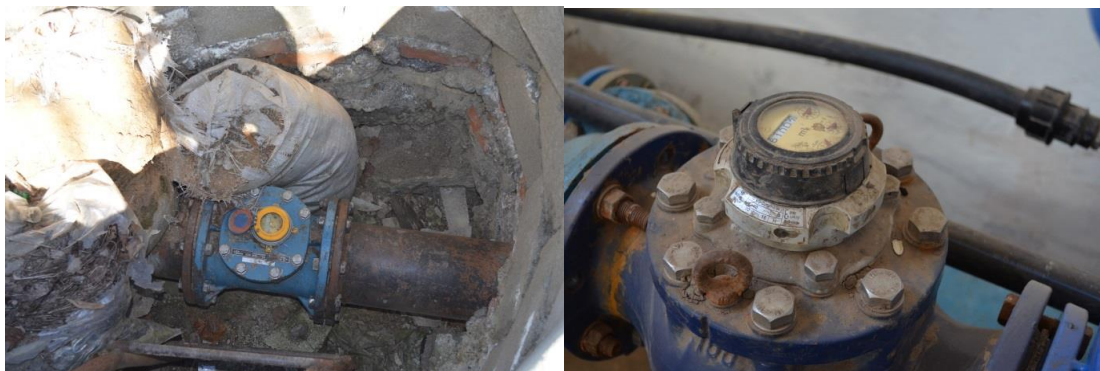
Figura 4-7: Stația de pompare a apei SP-3: nodul apometric care înregistrează volumul de apă la intrare și la ieșire din stație
