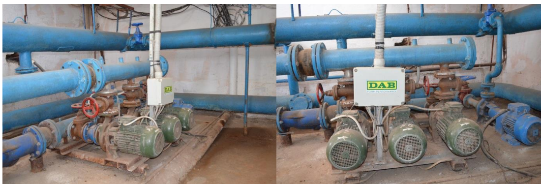
Figura 4-6: Stația de pompare a apei SP-3: agregatul de pompare DAB K50-800T
