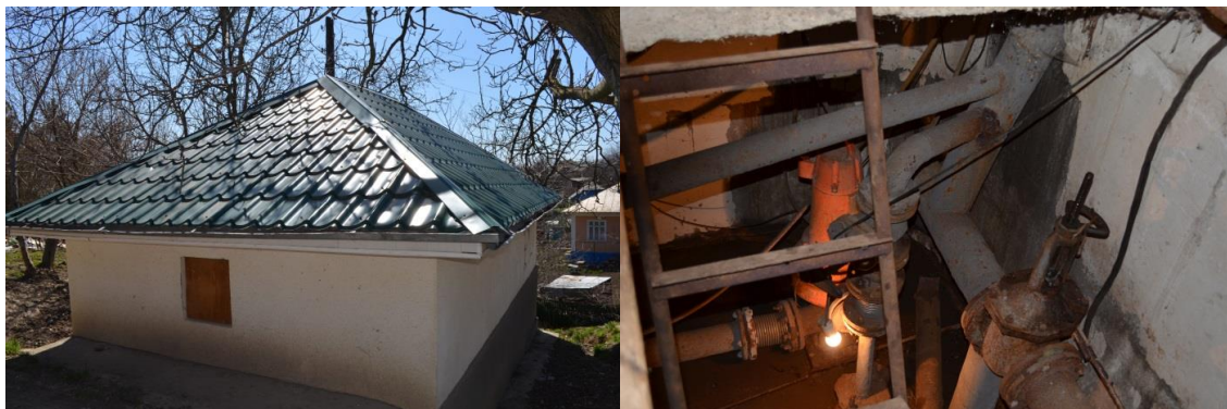
Figura 4-15: Stația de pompare a apelor uzate SPC-2: bazinul de recepție; sala motoarelor
