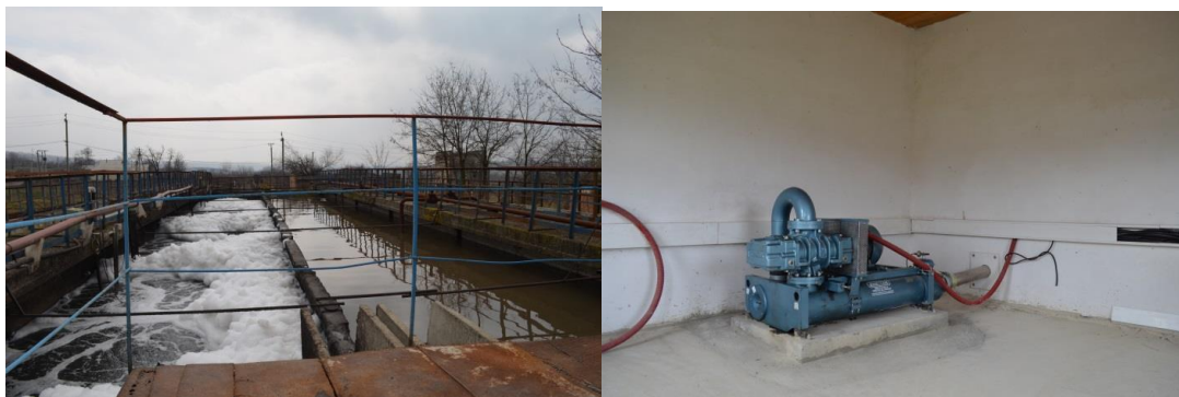
Figura 4-11: Stația de epurare a apelor uzate. Bazin de aerare cu nămol activ. Suflantă
