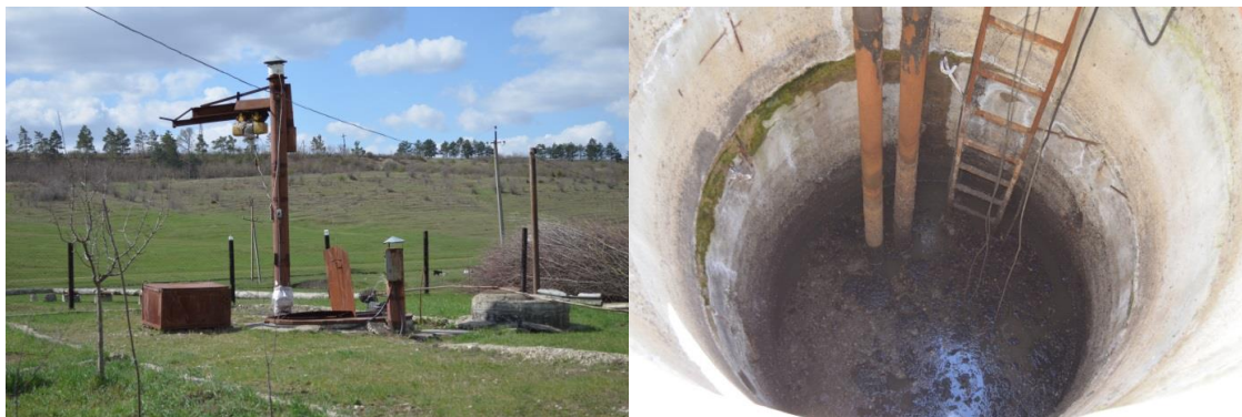
Figura 4-8: Stația de pompare a apelor uzate (SPAU)
