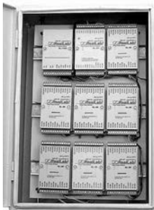
Рис.2. Внешний вид шкафа с аппаратурой
