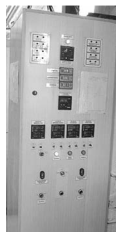
Рис. 1. Внешний вид щита управления после ремонта
