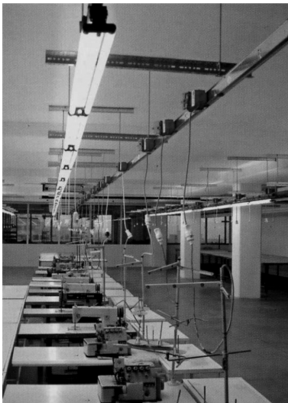
Рис. 1. Применение распределительных шинопроводов
