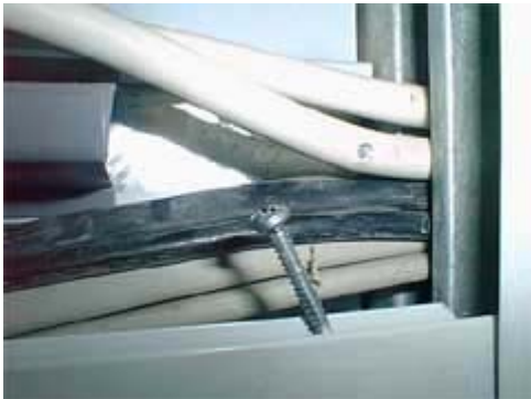
Повреждение изоляции жил кабеля линии питания розеток ввернутым в стену шурупом.
