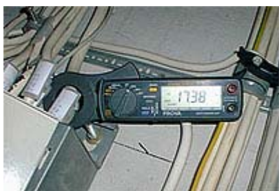
Ток утечки по данной кабельной линии составляет 17.38А установка УЗО невозможна
