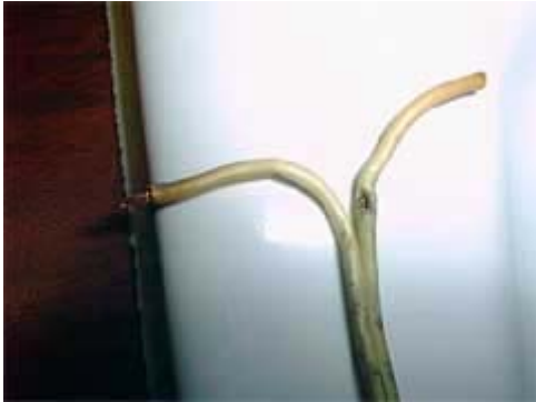
Повреждение изоляции нулевых рабочих проводников
