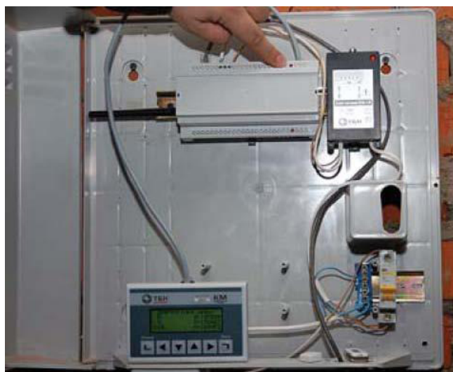
Рисунок 8. Домовой контроллер КМ-ДЗ в монтажном шкафу подключенной операторской панелью.
