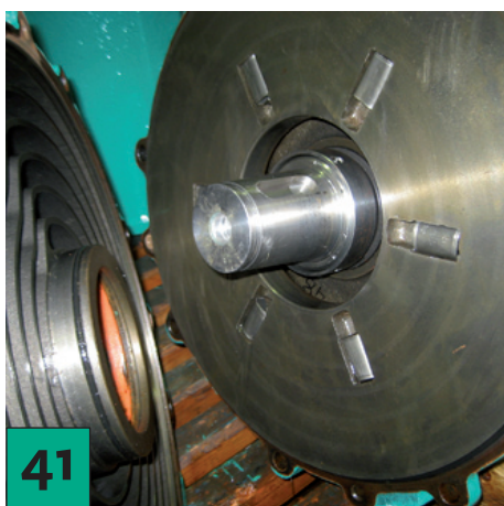
El sello mecánico superior queda descubierto.
