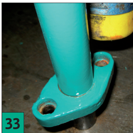
Retire la brida de la tubería de refrigeración.
