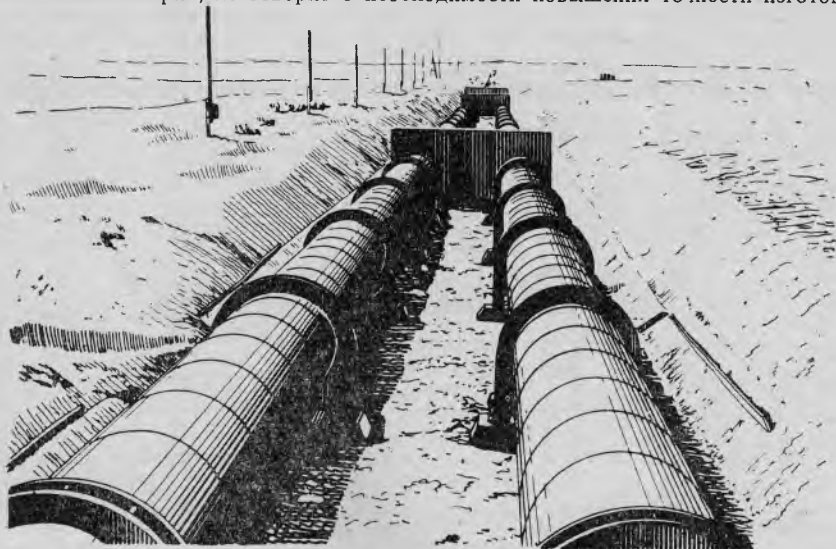
Рис. VII—20. Участок открыто уложенного стального трубопровода \varnothing 1700 мм. Видны промежуточные опоры каткового типа и анкерные опоры.
