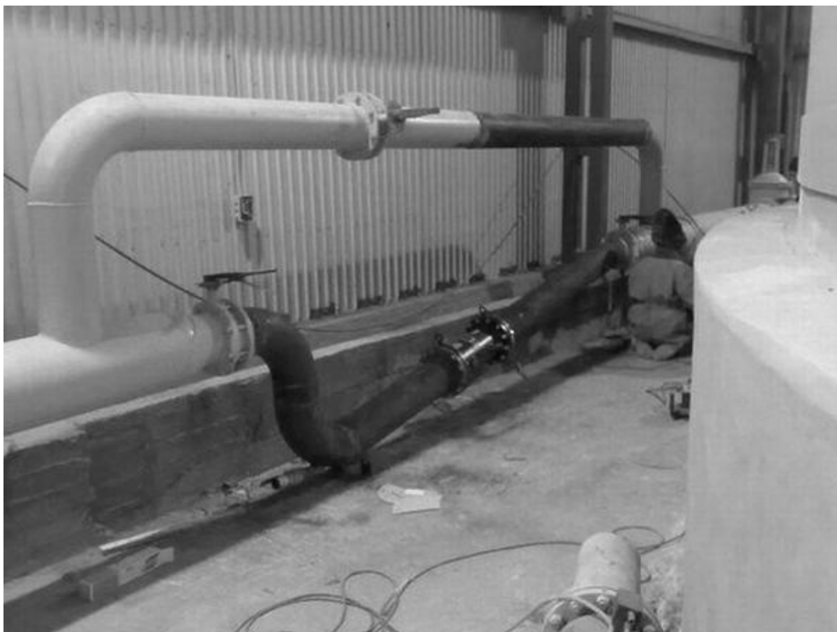
Ультразвуковой расходомер СВТУ-10М, смонтированный на напорном канализационном трубопроводе.
