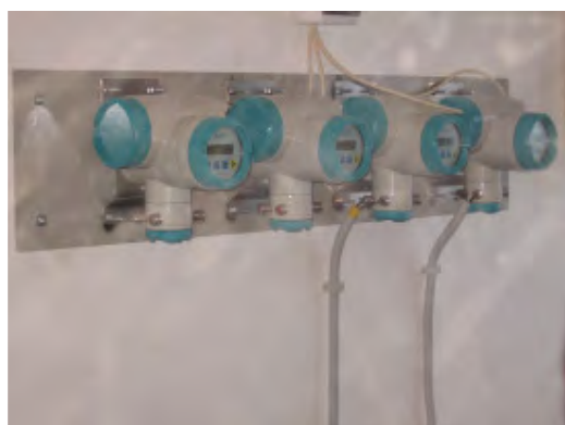
Figura 2.10-23: Debitmetre noi instalate
