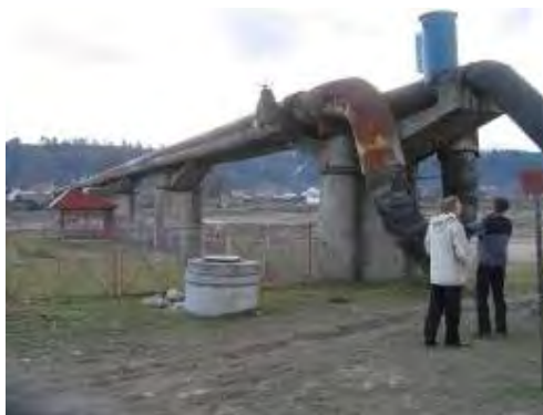
Figura 2.10-28: Supratraversare Râul Troțuș, avaria din 2005
