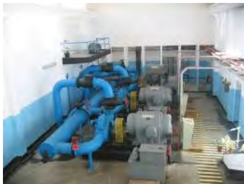
Figura 2.10-8: Stație de pompare Mărgineni
