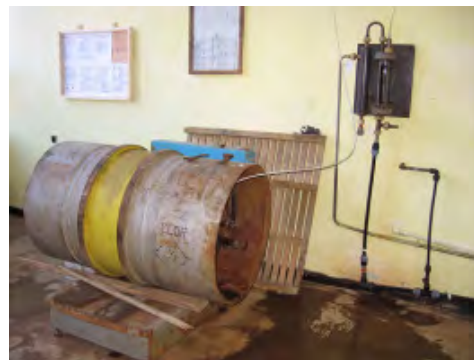
Figura 2.10-40: Echipament de clorinare
