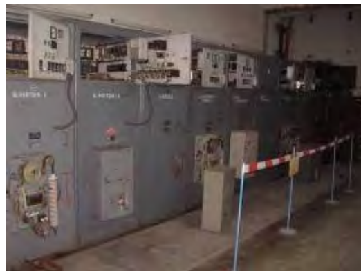
Figura 2.10-26: Panou control joasă tensiune
