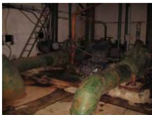
Figura 2.10-25: Pompe apă de spălare
