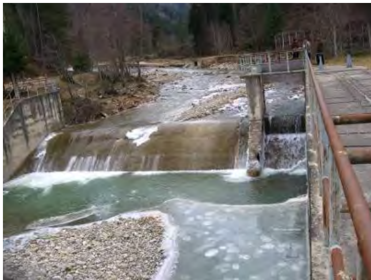
Figura 2.10-34: Captare la Râul Ciobănuș
