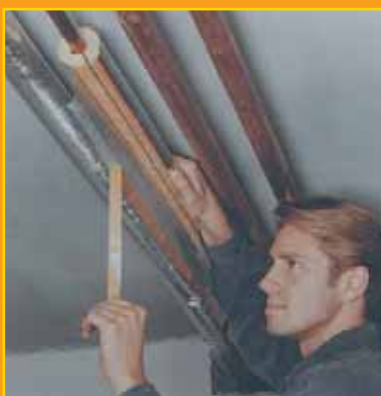
Рисунок 14. Теплоизоляция распределительных труб
