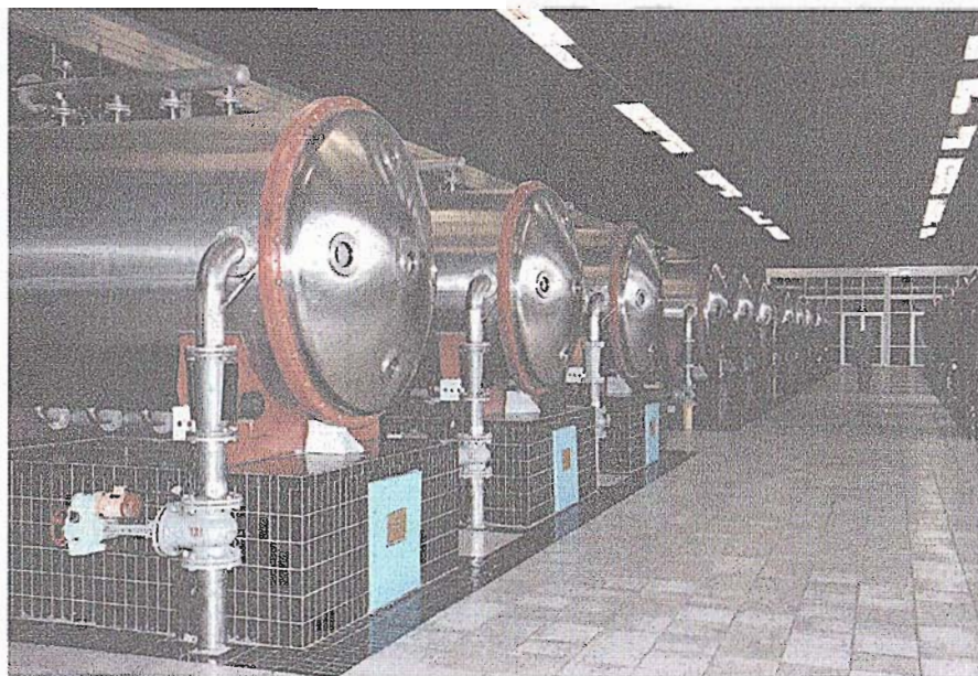
Установка озонирования воды на Восточной водопроводной станции
