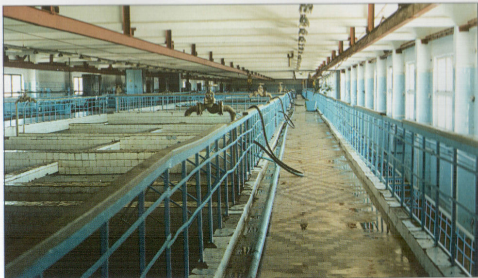
Sala cu filtre accelerate a Stației de Tratare Nistru. Зал скорых фильтров Очистной водопроводной станции из р. Днестр.
