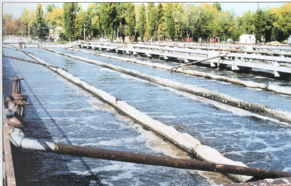
Stația de epurare biologică a apelor uzate. Funcționarea aerotancurilor. Станция биологической очистки стоков. Работа аэротенков.
