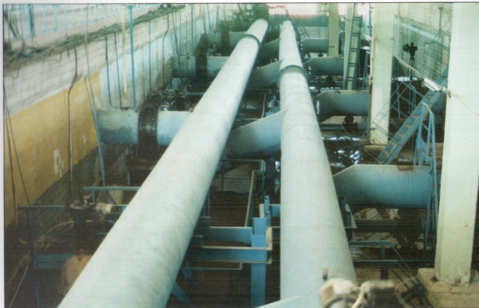
Galeria de filtre de la Stația de tratare a apei. Галерея фильтров на очистной водопроводной станции.
