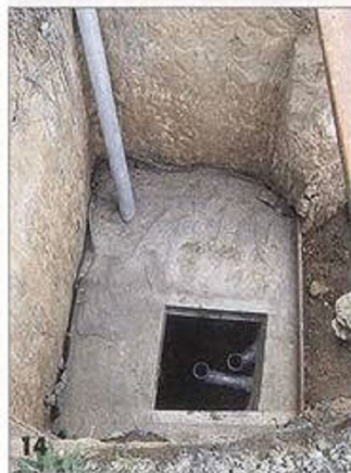
Септик с перекрытием и вентиляцией.
