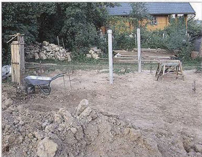
Канализационные стояки на поверхности.
