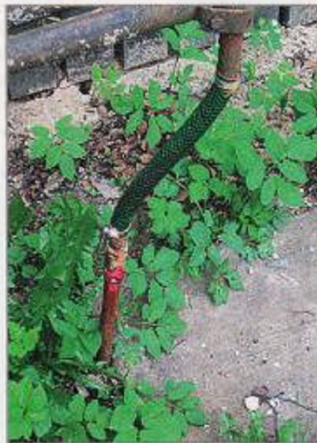
Вентиль на отводе от магистрального водопровода.
