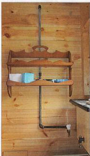
Внутридомовая разводка водопровода.
