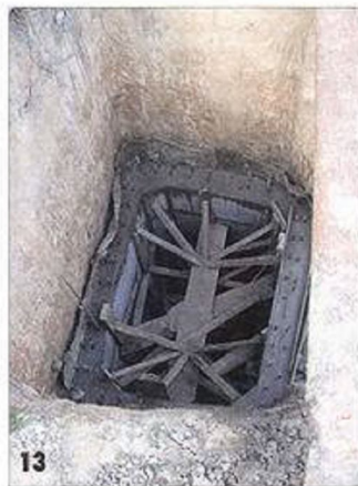
Залитый септик без перекрытия.
