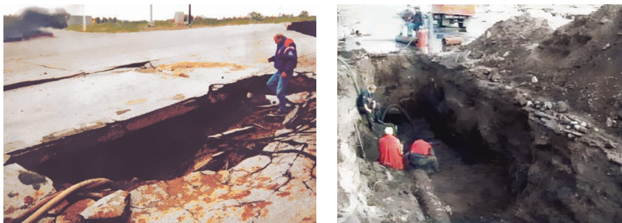
Рис. 6.20. Аварии на водопроводной сети
