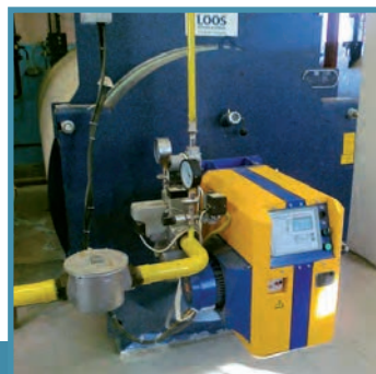
Горелочное устройство ГГВБ200 на котлах LOOS в котельной МК Щербинка, пос. Милицейский, Московская область
