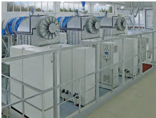
Рис. 5. Станция УФ-обеззараживания поверхностной воды, г. Нижний Новгород
