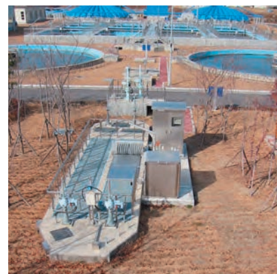
Рис. 6. УФ-станция лоткового типа наружного исполнения, г. Чхильгок (Южная Корея)
