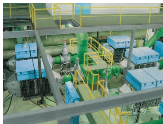
Рис. 2. Станция УФ-обеззараживания поверхностных вод, г. Череповец
