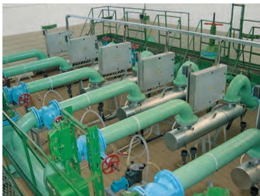
Рис. 1. Станция УФ-обеззараживания подземной воды "ВНС-2", г. Новокуйбышевск
