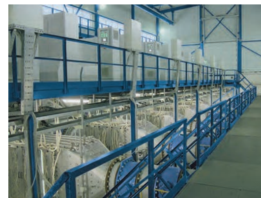
Рис. 3. Блок УФ-обеззараживания, Северная водопроводная станция, г. Санкт-Петербург
