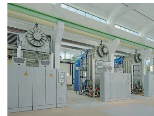
Рис. 4. Станция УФ-обеззараживания поверхностной воды, г. Будапешт (Венгрия)
