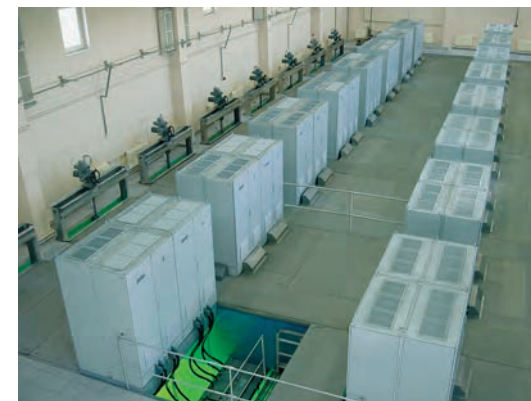
Рис. 7. УФ-станция лоткового типа, Люберецкие очистные сооружения, Москва
